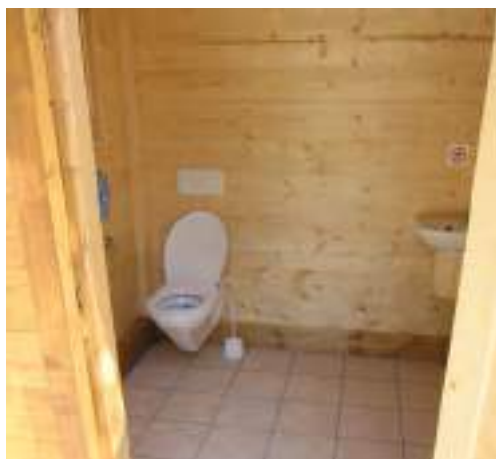
Toilettes raccordées aux réseaux
