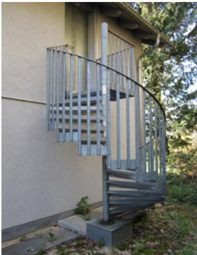
L'escalier d'évacuation de la salle communale de Jouxten-Mézery doit être réaménagé en priorité. Photo: Catherine Rouvenaz
